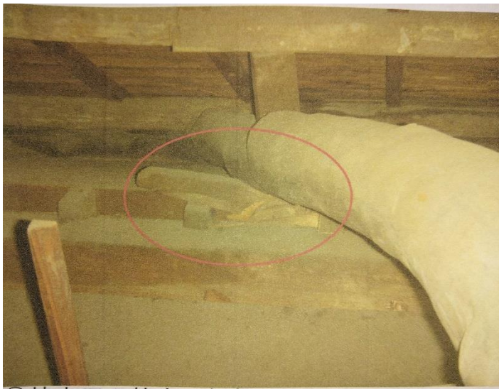
④ 桔木下の枕木の折損
